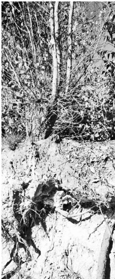
Erosión causada por las raíces de los eucaliptos. Foto: Leonardo Melgarejo
